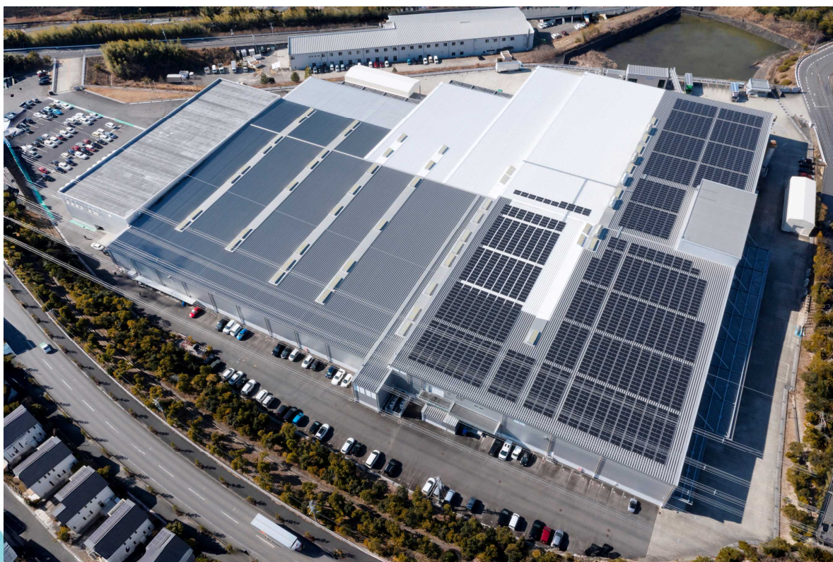
みよし事業所屋根に設置した太陽光パネル
